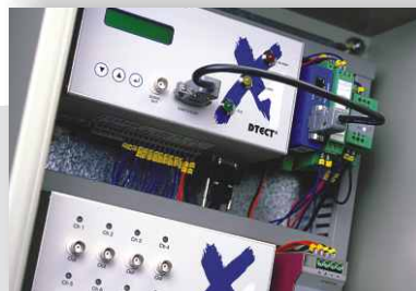
Dtect X1 (Monitoramento on-line)
